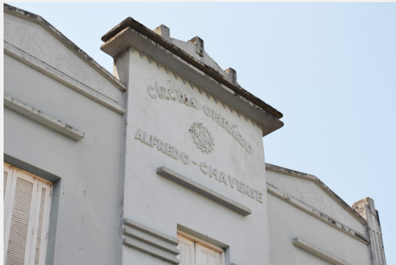
Detalhe dos frisos e inscrições em relevo na fachada frontal (Foto Helton Estivalet Bello, 2019)
