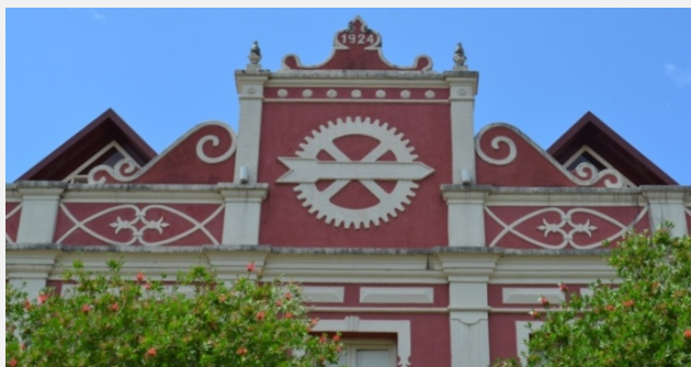
Detalhe do frontão e ornamentos sobre o corpo central da fachada oeste (Foto Helton Estivalet Bello, 2020)
