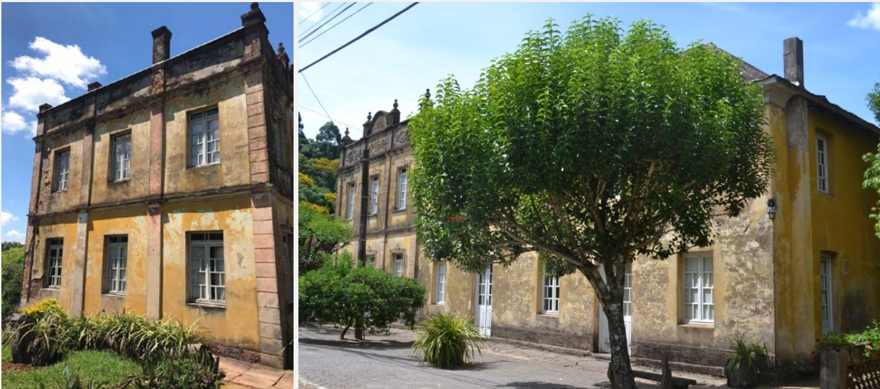
Aspecto das fachadas norte, oeste e sul da edificação (Fotos Helton Estivalet Bello, 2020)
